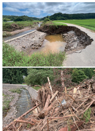
7 月豪雨での西目地域の被害状況
